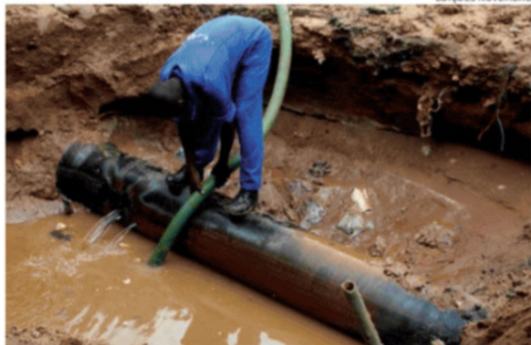
Destruição de conduta de água dá pena de cinco a dez anos
